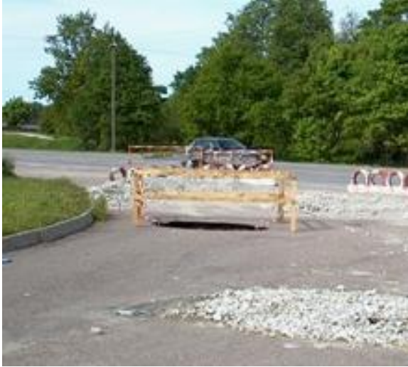
а – провал на автодороге;
