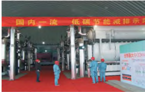
Рисунок 3 – Теплонасосное оборудование ТЭЦ г. Янгжин
