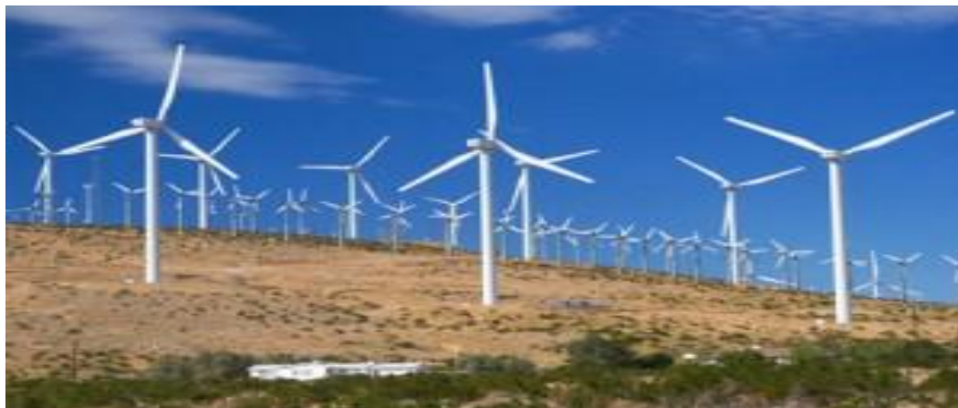
1-сурет. Жел электр станциясы
