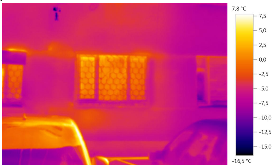
Рис. 2. Термограмма наружной поверхности панелей в зоне стыковых соединений
