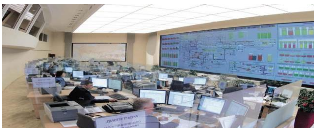
Центр управления перевозками на железнодорожном транспорте с помощью спутника
