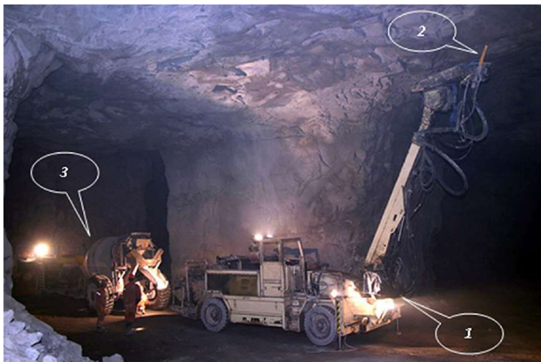
3-сурет – Тазалау камераларын бекітпелеу, Sprautес (1) қондырғысы (Финляндия): 2 манипулятордағы сопло; 3 – бетон қоспасын жеткізуге арналған миксер
